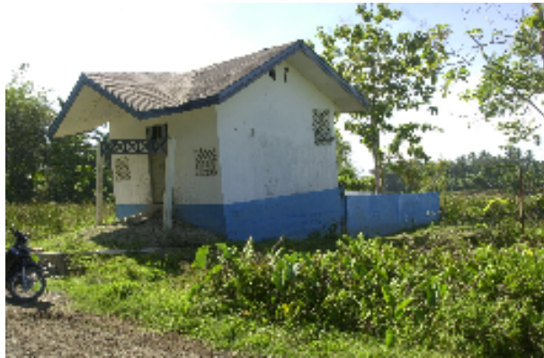
写真 2 2004年スマトラ島沖地震の際のムラボーにおける取水場の被害
