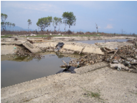
写真 1 2004年スマトラ島沖地震の際のバンダ・アチェにおける下水の終末処理場の被害
