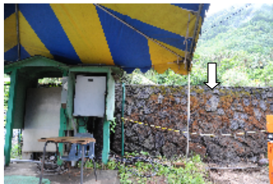
写真 4 2009年サモア諸島沖地震の際のアピアにおけるマンホールポンプの水没後の状況
