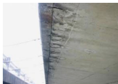
写真-2 張出床版部の損傷例
