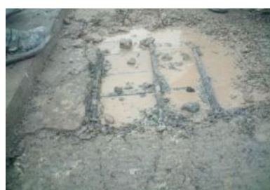
写真-3 鋼橋床版の損傷例
