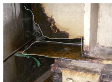
写真-1 桁端部の損傷例
