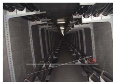
写真 3.4-1 洞道の被害 (傾斜)
