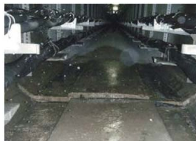
写真 3.4-2 洞道の被害 (段差)
