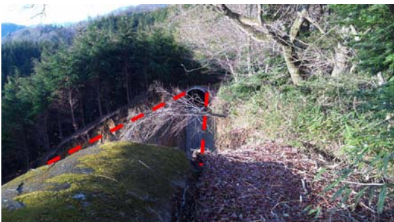
写真 3.3-1 被災状況 (図 3.3-3 中①より臨む)
