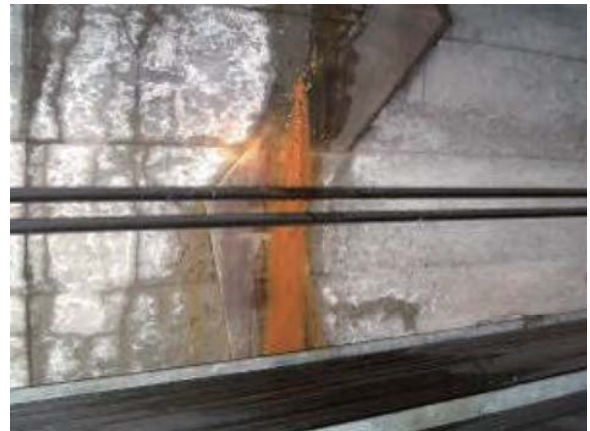
写真 2.3-2 南北線における漏水増加箇所②
