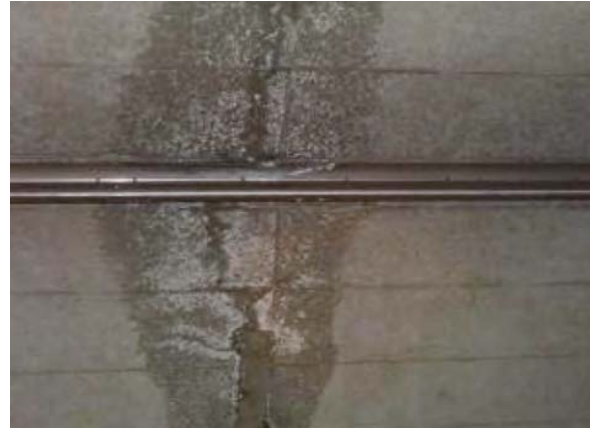
写真 2.3-1 南北線における漏水増加箇所①
