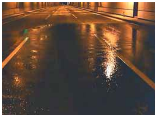
写真 3.2-1 開削トンネル継目からの漏水
