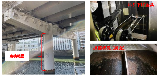
写真-3 鋼製橋脚柱内部の点検状況と損傷状況
