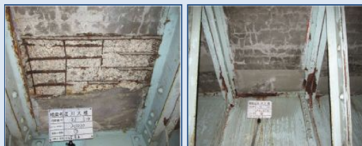
剥離・鉄筋露出
