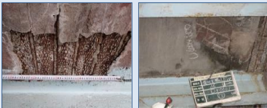
剥離・鉄筋露出
