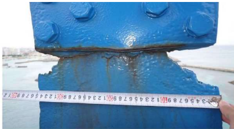
フランジの断面欠損
