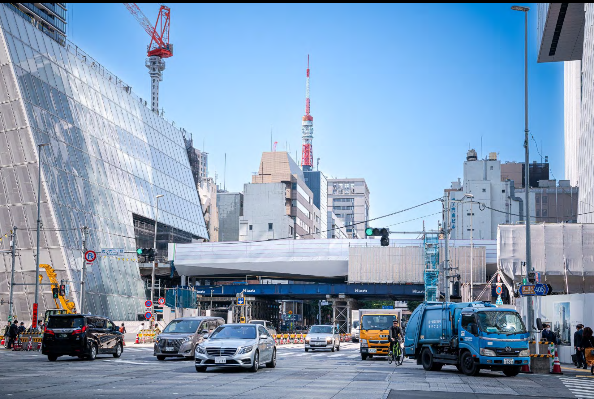
供用中の国道上に架ける橋のため、仮設構台上での現地施工
