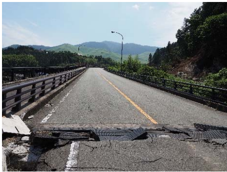
(a) 伸縮装置部の段差（ジョイント損傷）
