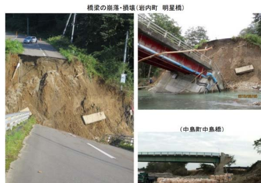
(b) 被害状況 22)
