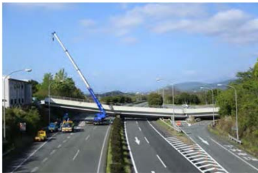
(a) 跨道橋の落橋 2)
