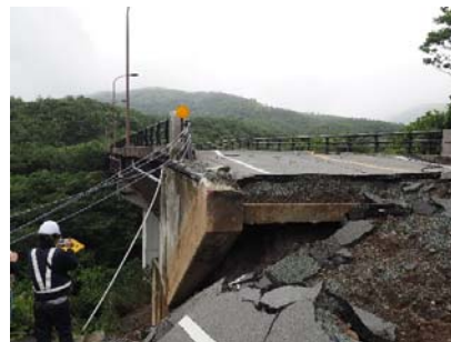
(d) 橋台背面の崩落
