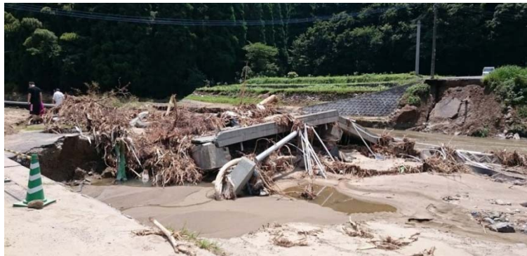
写真-2.2.2 流出した橋梁（朝倉市，名称不明）
