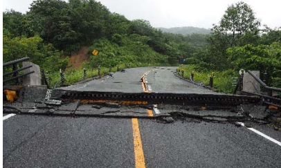
(a) 橋梁の伸縮装置部に生じた段差
