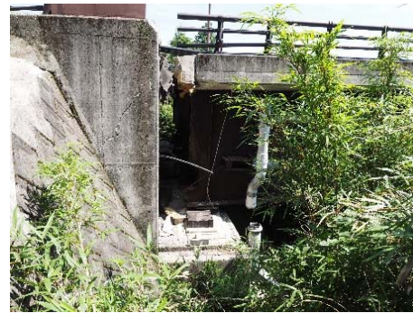
(b) 支承の損傷
