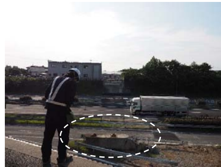
(b) 橋脚基部の一部崩壊
