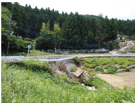
(a) 路肩の崩落
