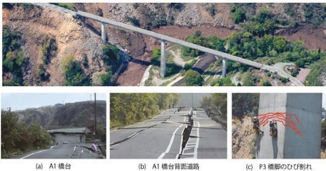
写真-Ⅱ.1 阿蘇長陽大橋の被災状況 2)
