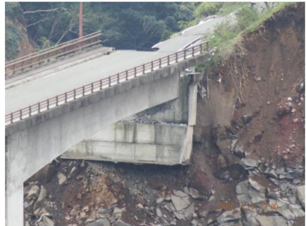
(c) A1橋台の損傷 (4月18日撮影)
