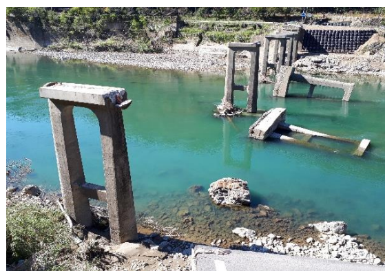
写真-4.3.7 神瀬橋の流出状況
