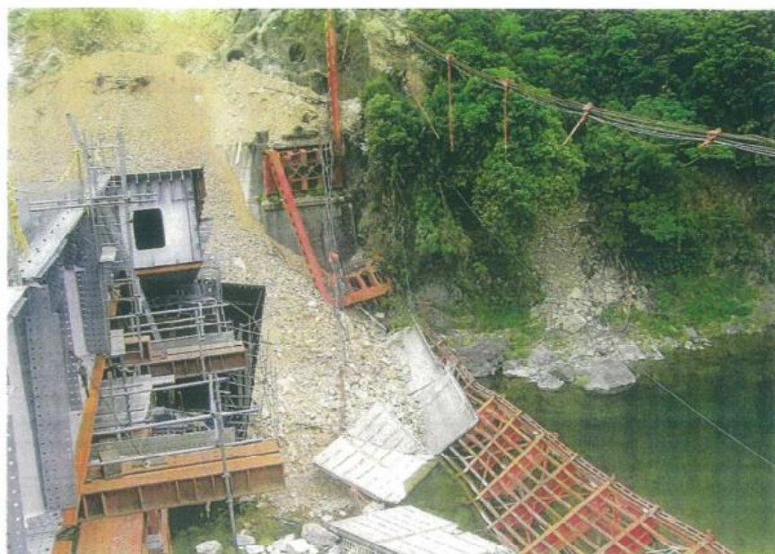
写真-Ⅱ.8 架設中の新原田橋（左）、旧原田橋（右）の被災状況 (提供：瀧上工業株式会社)
