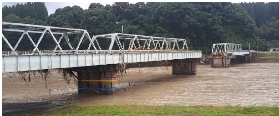
写真-4.3.5 西瀬橋の流出状況 17)
