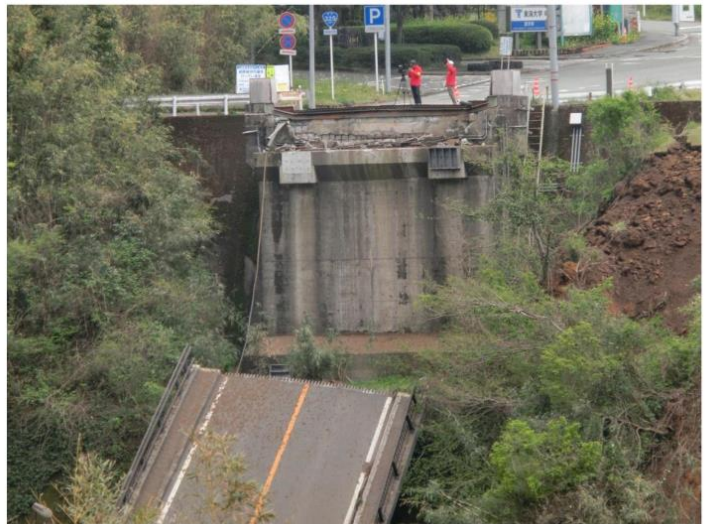
(b) A2 橋台 (正面) (右岸側から撮影) 上部構造の落下状況
