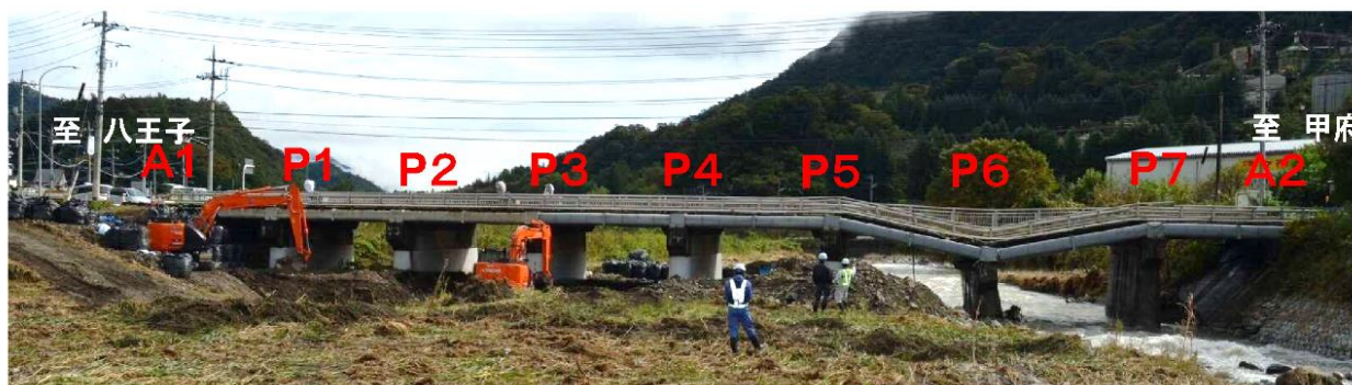
写真-Ⅱ.14 法雲寺橋橋脚沈下状況 12)
