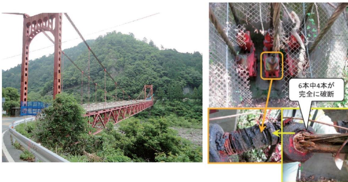
写真-Ⅱ.7 旧原田橋の損傷状況 8)
