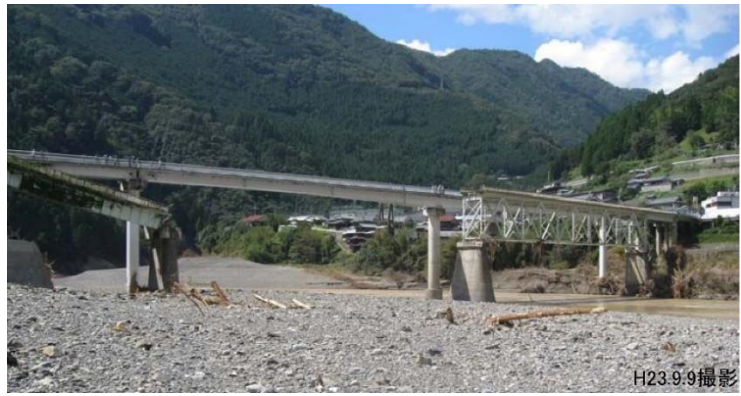
写真-4.3.3 折立橋の被災後状況 14)
