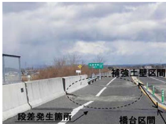
写真-Ⅳ.1 橋台背面アプローチ部の段差事例 2)
