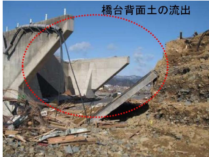
写真-IV.3 津波による橋台の被災 6)
