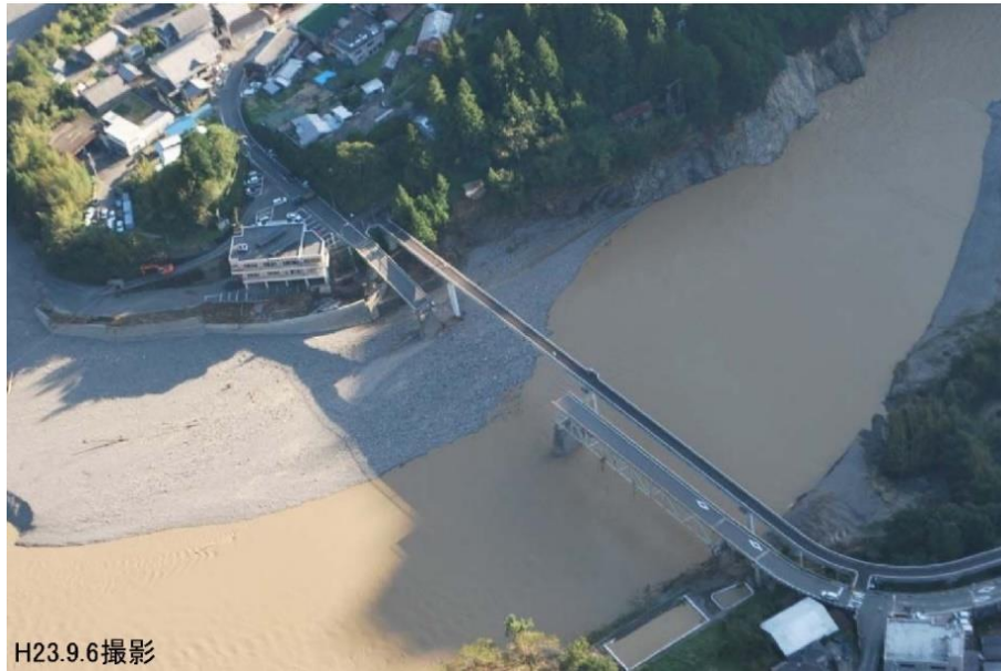
写真-Ⅱ.9 折立橋の被災状況 9)
