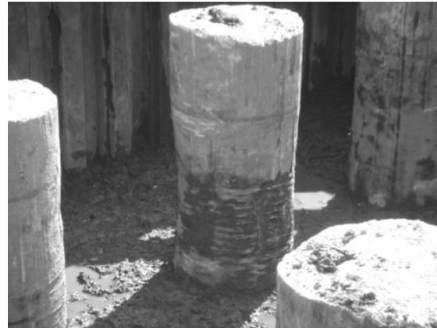
写真-IV.4 杭頭の細り 9)
