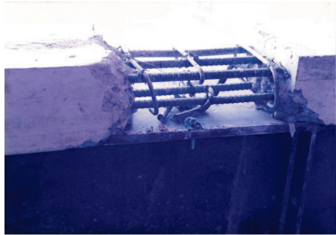
スラブ止めの破断状況
