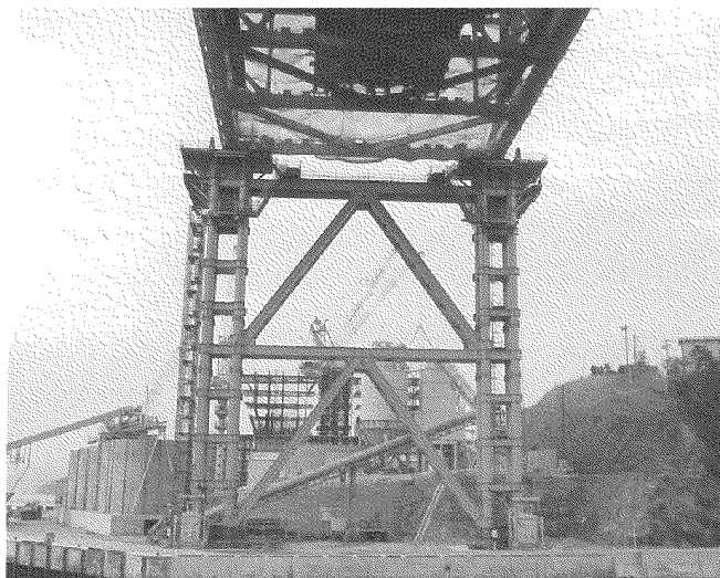
写真 7.12.3 大型ベントの使用例
