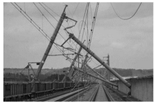
2011.3.11 電化柱 東北新幹線 想定外？
