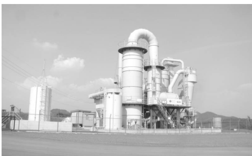
処理プラント
