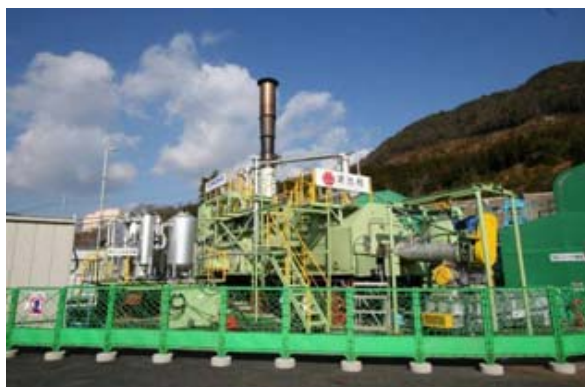
間接熱脱着設備実機 全景
