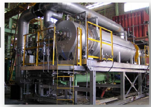
還元加熱炉の外観
