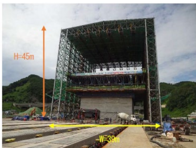
写真-4 港湾の岸壁や防波堤のケーソン側壁部を構築するガントリースリップフォーム工法
