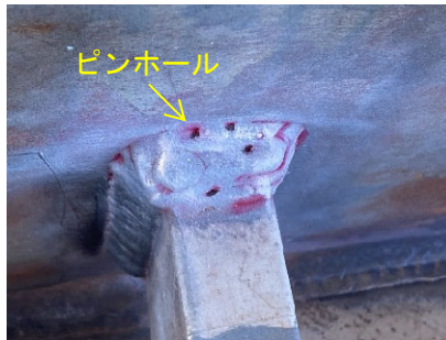
写真-7 溶接不良の例
