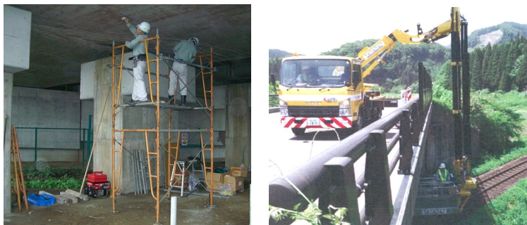
図-1 近接目視によるコンクリート構造物のひび割れ点検状況
