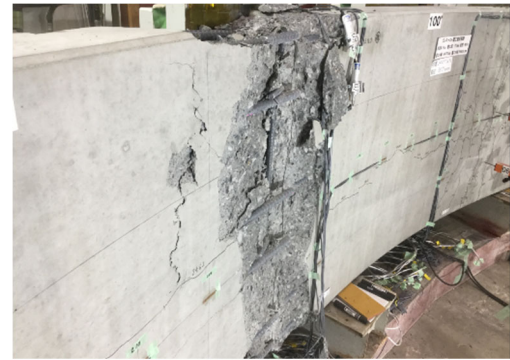
写真-7 110° 内面側の破壊状況 (第2ピーク後)
