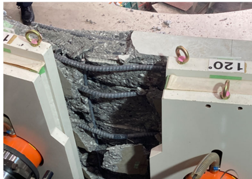
写真-6 110° 外面側の破壊状況 (第2ピーク後)
