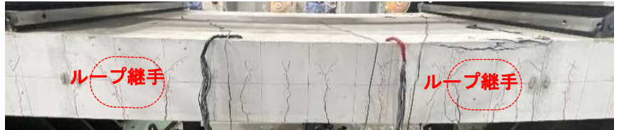
図-13 試験終了時のひび割れ状況 (LoS-ST)
