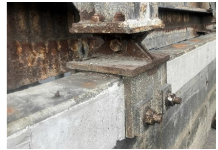
写真-6 支承部の発錆状況
