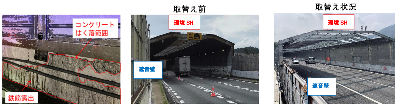
写真-2 既設壁高欄の劣化状況
