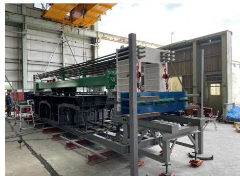
写真-3 移動式プレテン架台
