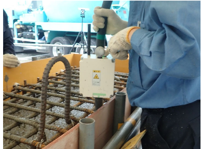
写真-1 バイブレータ位置計測システム
