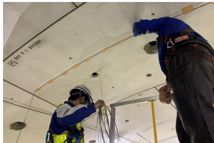
図-4 光ファイバ設置状況
