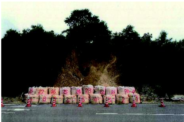
図-9 2011年6月の豪雨によるのり面崩壊
