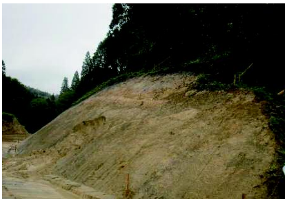
図-2 2017年10月17日に発生したのり面小崩壊
