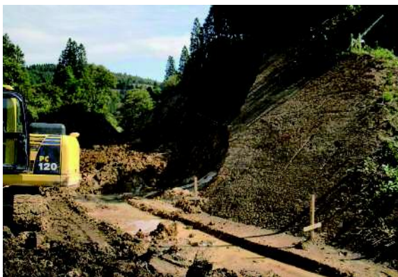
図-3 2017年10月24日に発生したのり面大崩壊
