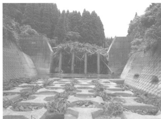
写真-7 古恵川第11号砂防堰堤による流木捕捉
