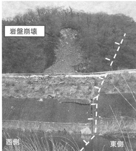
写真-5 IV地区の岩盤崩壊と地震断層部の擁壁損壊(破線:地震断層位置)
