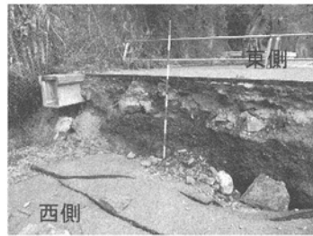
写真-6 IV地区の地震断層(西側約1.2m低下)
