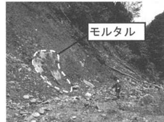
写真-10 I地区ののり面残存部(破線内)
