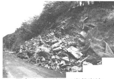
写真-3 II地区の岩盤崩壊
