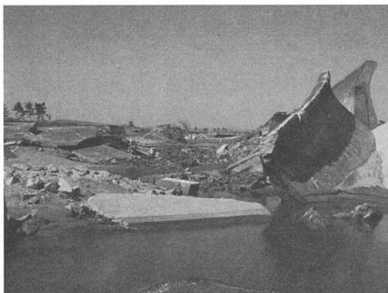
写真-10 津波による防潮堤背面の侵食 (山元町磯浜地区)
