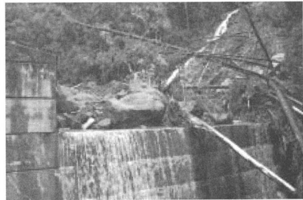
図-5 阿蘇市における治山堰堤被災例(本体上部損壊)
