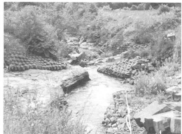
図-2 久著呂川における根固ブロックの状態
