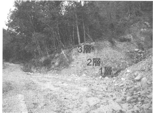
写真-2 奈美地区 土石流堆積状況
