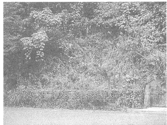
写真-1 03崩壊例 (no. 12)
