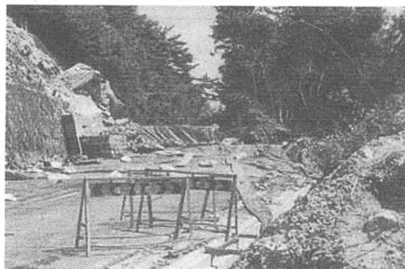
写真-6 道路の亀裂の拡大(7/24) 1)
