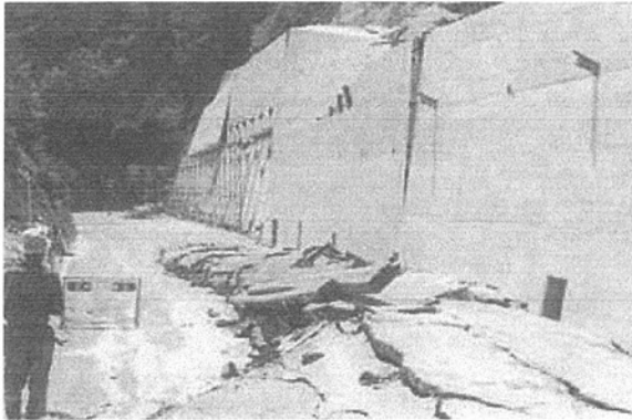
写真-7 道路の亀裂と擁壁の腹み出し(7/24) 1)
