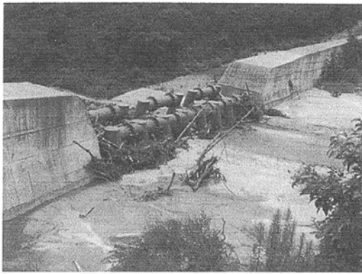
写真-7 ダムの鋼製スリット下端辺りまで堆積した状態 (八幡谷溪流の堰堤)
