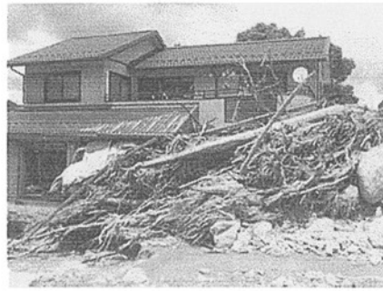
写真-2 土石流の直撃を受けた家屋 (No. 1 右岸側に位置)
