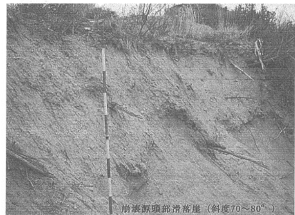
写真-4 崩壊源頭部の滑落崖
