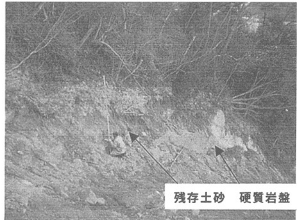
写真-4 硬質岩盤の上方に土砂が残存している。
