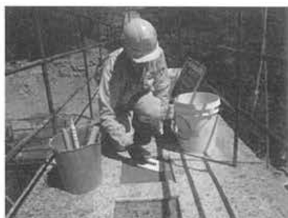
写真-4 コンクリート構造物天端における付着強度試験の状況
