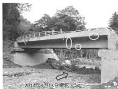
写真-7 丸駒橋上流側桁の衝突痕の状況
