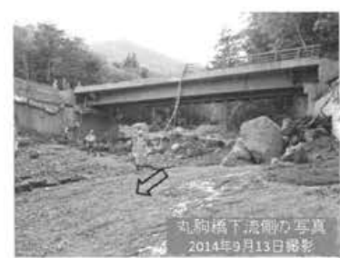
写真-9 下流側から見た丸駒橋と流下した歩道橋の橋台
