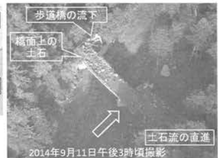
写真-2 歩道橋が流下した丸駒橋と左岸側橋面の堆積土石
