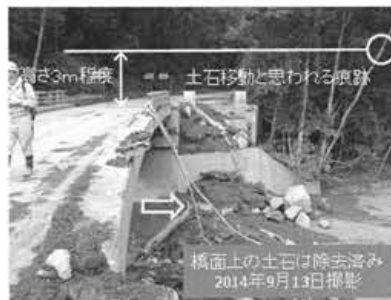
写真-5 丸駒橋左岸下流の樹幹に残った土石流の痕跡
