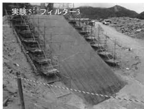
写真-3 降雨開始から2時間後の斜面状況
