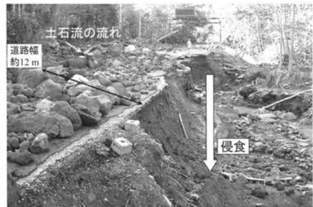
写真-2 土石流による国道北側の侵食状況
