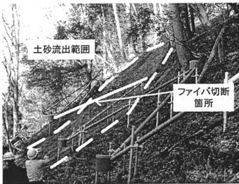
写真-5 崩壊箇所のセンサの状況
