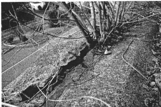
写真-3 構造物の隙間に侵入した樹木
