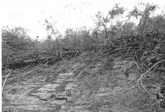
写真-5 のり面の表層崩落
