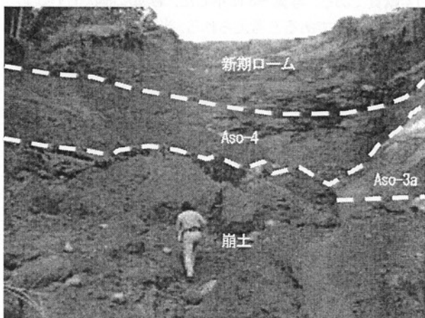
写真-4 瀬口地区、崩壊斜面の地質区分 (2006. 10. 26 撮影)
