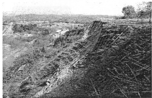
写真-9 ずり落ちた吹付け法砕工(2004/11/28)
