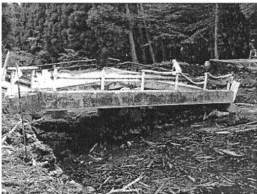
写真-4 破損した石原橋 (上流から下流方向を望む)
