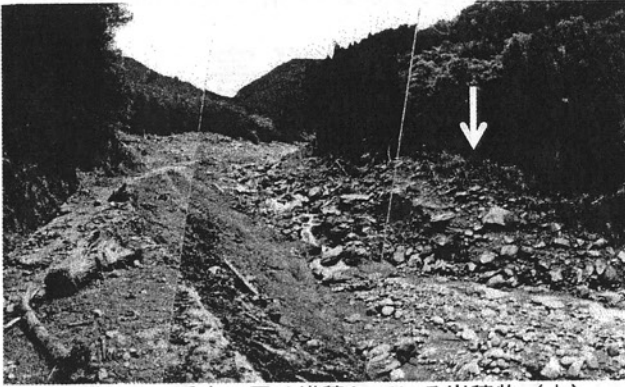
写真-1 溪床に厚く堆積している崩積物(↓)
