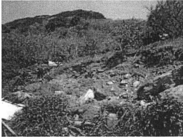
写真-11 余震などで生じた玄界島南側農地の崩壊
