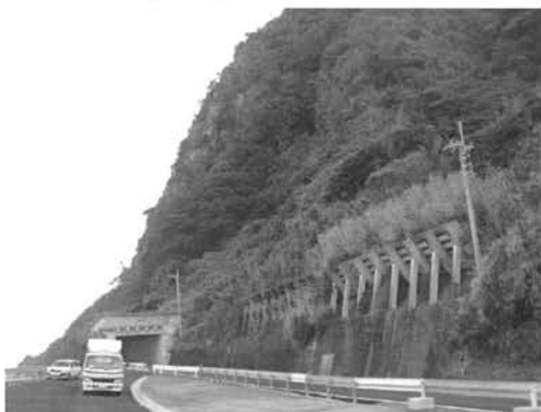
写真-1 伊座敷～浮津区間 I (亀裂区間)
