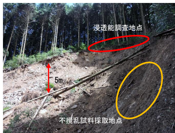
図-2 源頭部被害状況
