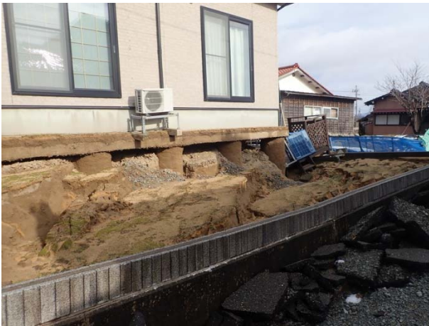
写真-3 家屋基礎柱状改良と周辺地盤の側方流動
