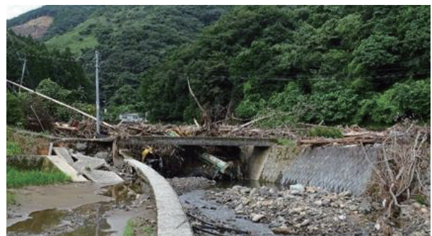
写真-1 令和 2 年 7 月豪雨での橋梁閉塞の事例
